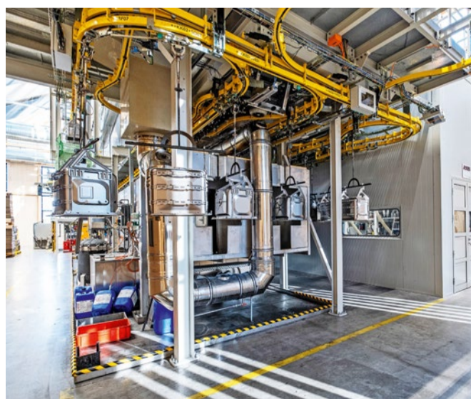
Die 5-Zonen-Spritzvorbehandlungsanlage entfernt alle Verunreinigungen der mechanischen Fertigung.
